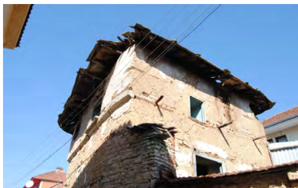
Dëmtimet në konstruksionin e kulmit
