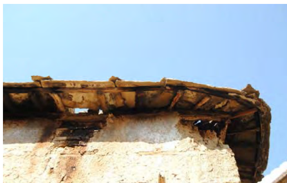
Dëmtimi në konstruksionin e kulmit dhe mbulesën
